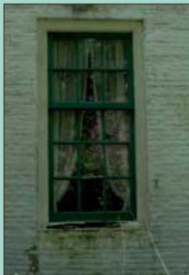
Verf bladdert van de raamkozijnen.
